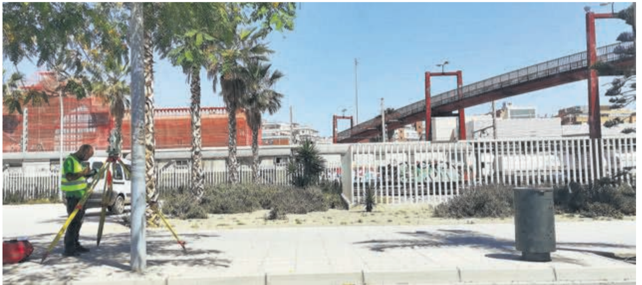
OPERARIOS ya están trabajando en las inmediaciones de la Carretera de Sierra Alhamilla junto al puente rojo. LA VOZ
